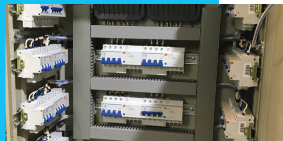
ГРЩ с АВР для административно-бытового комплекса «Роснефть» Компания ООО «Бонпет»
