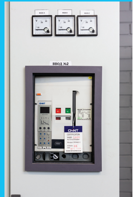
Вводное распределительное устройство ООО «Автоматика водоснабжения»
