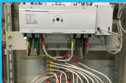
ГРЩ 315А с АВР. Гостиничный комплекс Компания ООО «Бонпет»
