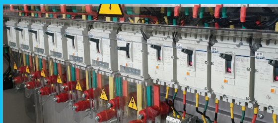
Киосковая ТП 400кВА. Компания «Блисс Инжиниринг»
