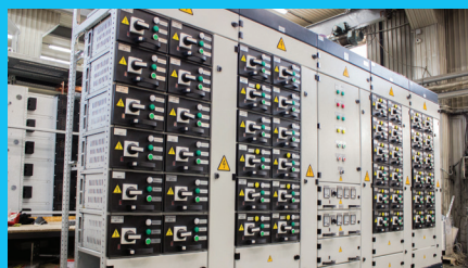
Щит управления задвижками. Компания ООО Промэлектросервис
