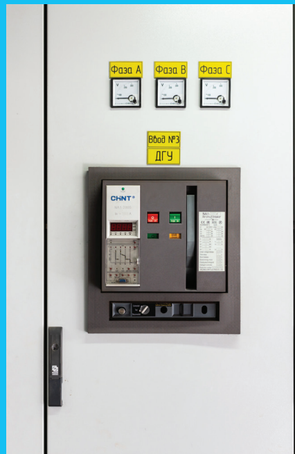
Главный распределительный щит ООО «Автоматика водоснабжения»
