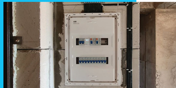
Электрощит для двухкомнатной квартиры, площадью 65м², Махачкала
