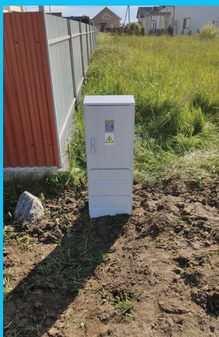
Уличный щит учета электроэнергии. Коттеджный поселок, Калининградская область
