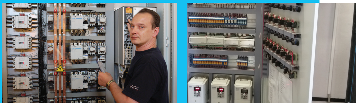
Система управления насосами повышения давления. ООО "ЭТК «Бортек»
