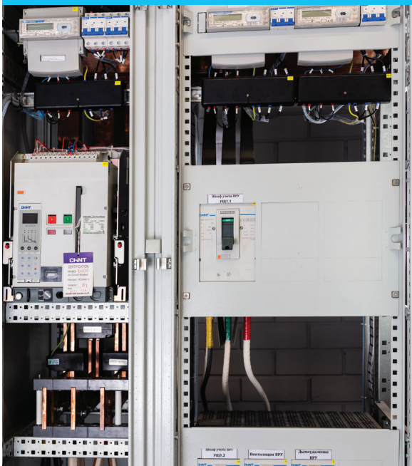
Вводное распределительное устройство ООО «Автоматика водоснабжения»
