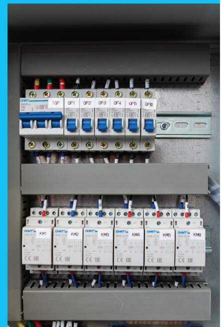
Щаф управления освещением ООО «Автоматика водоснабжения»
