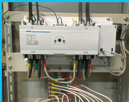
ГРЩ 315А с АВР. Гостиничный комплекс Компания ООО «Бонплет»
