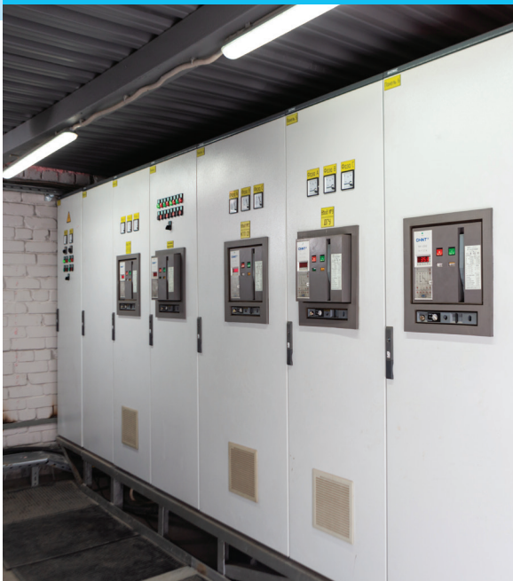
Главный распределительный щит ООО «Автоматика водоснабжения»
