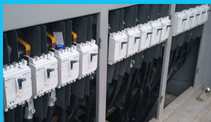
Трансформаторная подстанция 110/10 кВ. Компания ООО «Ростовэнергоспецмонтаж»
